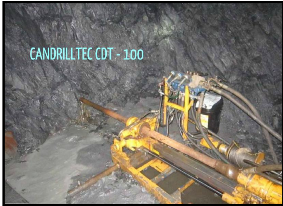
Figura 36. Máquina diamantina empleada para la exploración de estructuras y obtención de núcleos de roca, mina El Gran Porvenir.
