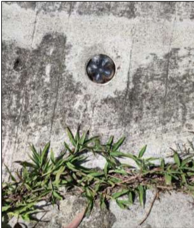
Figura 31. Fotografía del dren perteneciente al manejo de aguas subsuperficiales de la obra de mitigación aledaña obstruido por una botella de plástico. Fuente: propia.
