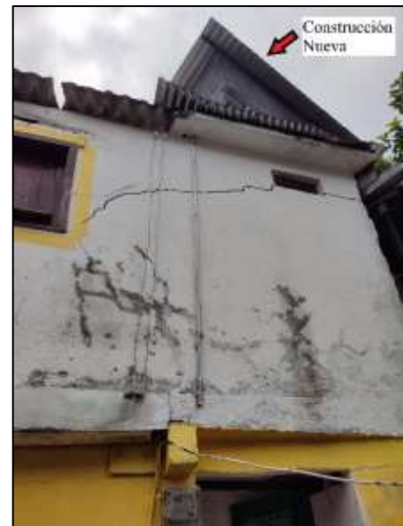
Figura 18. Fotografía tomada a la fachada trasera de la vivienda donde se evidencian los agrietamientos en la zona más cercana a la nueva construcción. Fuente: propia.
