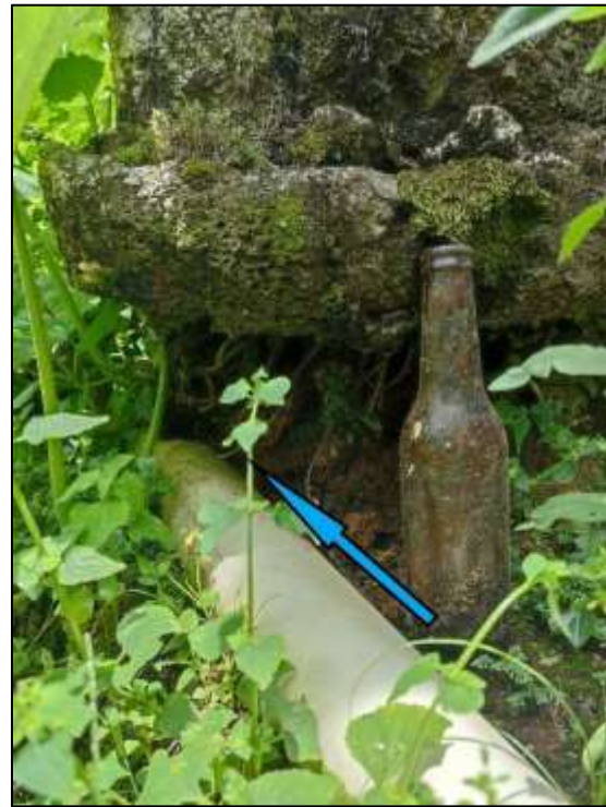
Figura 14. Base del baño del predio de la visita 2 donde se evidencia socavamiento por mal manejo de aguas lluvias. Fuente: propia
