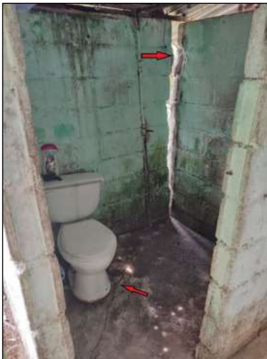
Figura 13. Baño de la vivienda de la visita técnica 2 donde se evidencia grietas y fracturas. Fuente: propia
