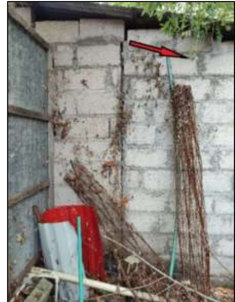
Figura 12. Habitación en el predio de la visita técnica 1, se evidencia una grieta mostrando la dirección del asentamiento. Fuente: propia.
