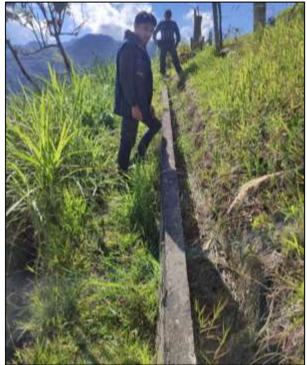
Figura 32. Fotografía tomada a la zanja de corona perteneciente a las obras de manejo de aguas superficiales, obstruida por material vegetal. Fuente: propia.
