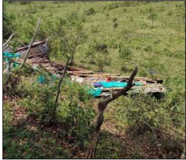
Figura 41. Fotografía de la cobertura de vivienda en guadua y hojas de zinc desprendida por el vendaval. Fuente: propia.
