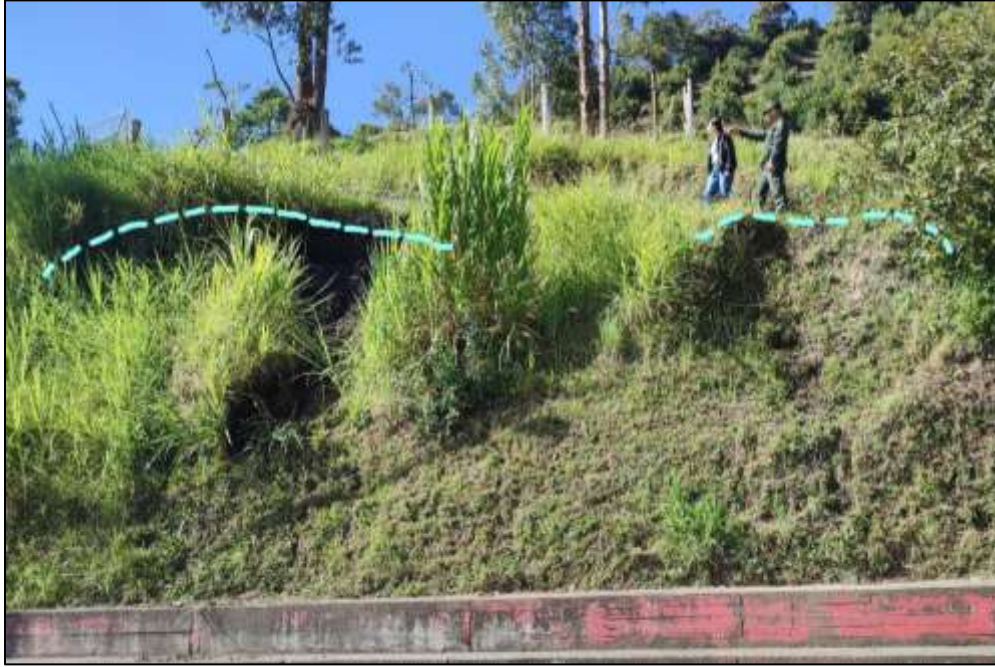
Figura 28. Fotografía de la ladera estudiada en la visita técnica 6; se evidencian las dos coronas presentes (líneas azules). A la izquierda corona activa (4 metros), a la derecha inactiva (1,5 metros). Fuente: propia
