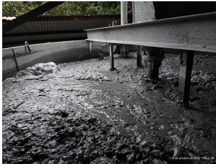
Figura 81. Tanque de cianuración en el que se evalúa visualmente la calidad de la carga.
