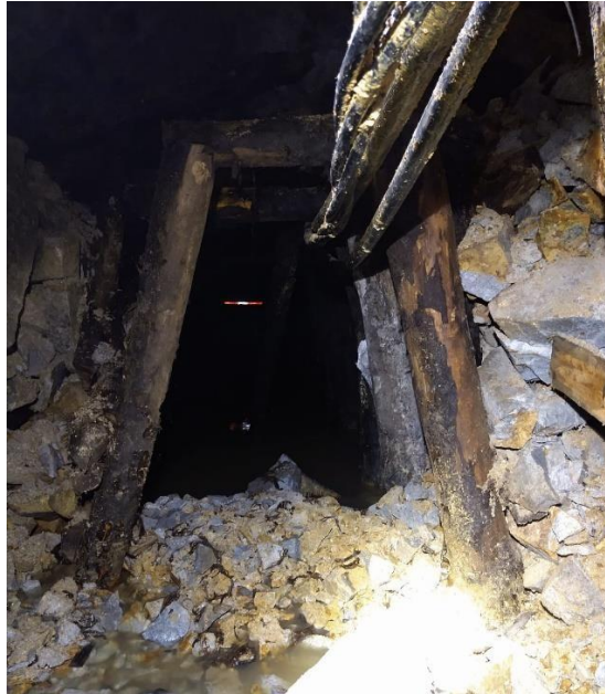
Figura 15. Colapso de siete puertas en el crucero 1858 (Mina Guayabales).
