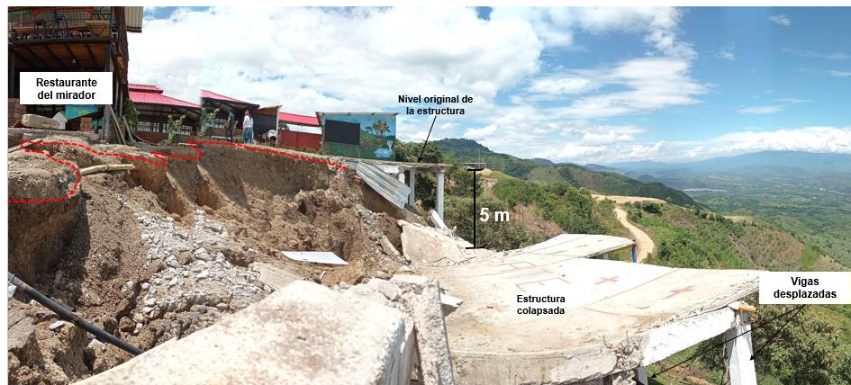
Registro fotográfico 9. Imagen corona del deslizamiento presentado en el mirador Monserrate. Imagen tomada y editada por fuente propia.
