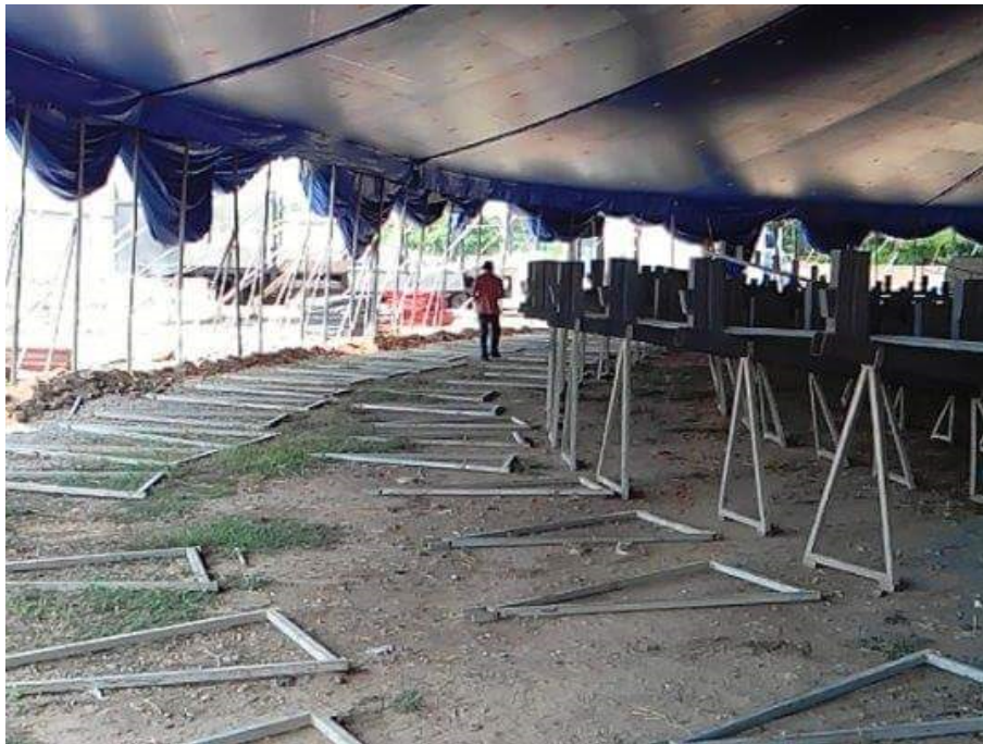
Fotografía 9. Tijeras escalonadas. 25/09715. Valledupar, Cesar. Fuente: Propia.
