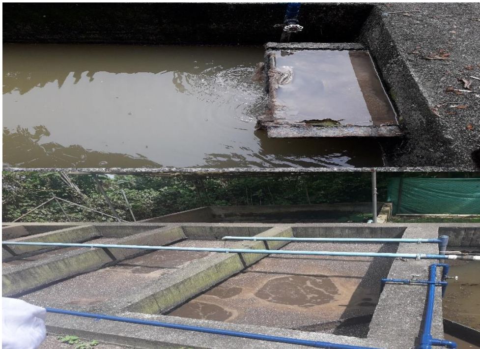
Ilustración 8. Planta de tratamiento de Aguas Residuales de un Hospital de Salud Pública.
