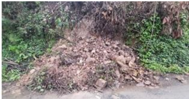
Figura 24. Movimiento en masa de tipo caída de rocas.
