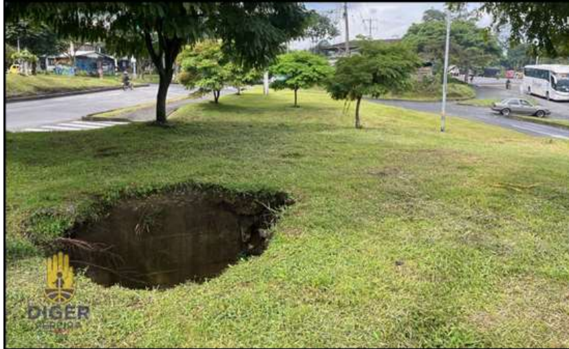
Fig 29. Fenómeno ocurrido en Parque Industrial en el 2022. Fuente: (DIGER, 2022).
