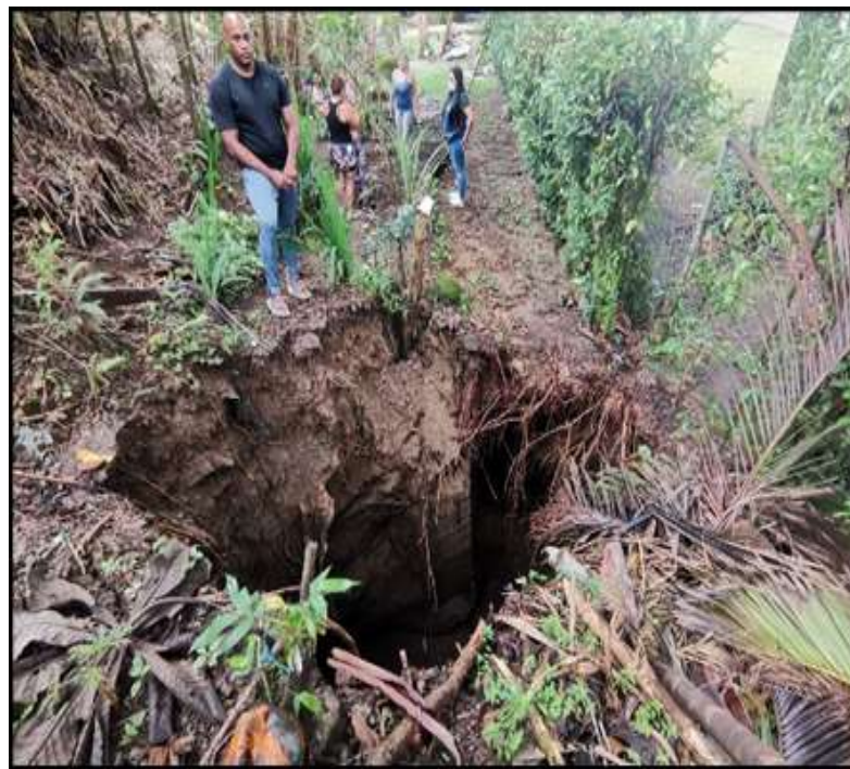
Fig 30. Fenómeno ocurrido en Villas de la Madrid en el 2021. Fuente: (DIGER, 2021).
