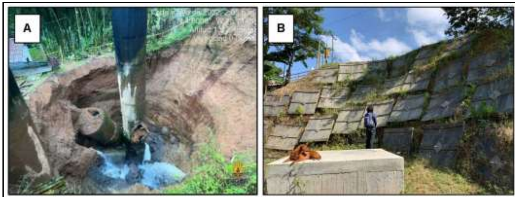
Fig 24. A) Evento de subsidencia ocurrido el 24 de julio de 2021. Fuente: (DIGER, 2022). B) Actual obra de contención en la zona.
