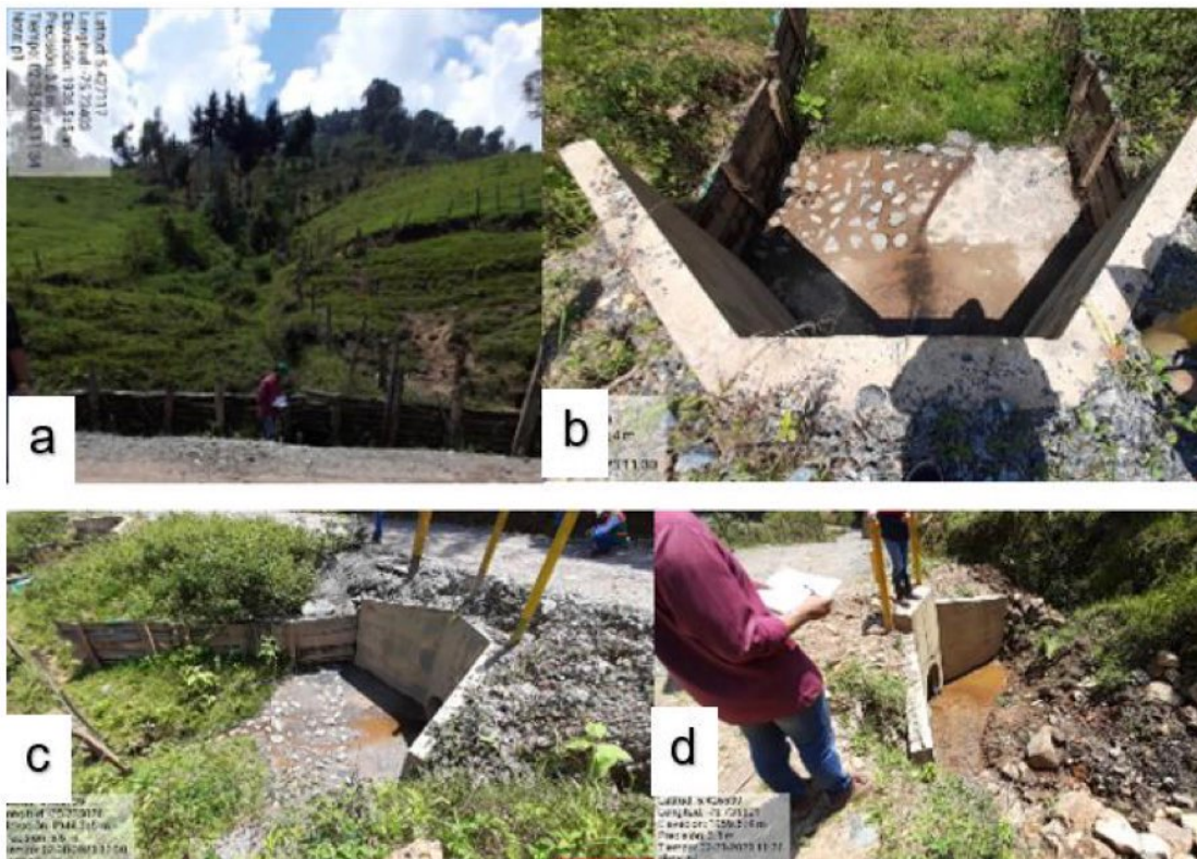
Imagen 9. Collage de lo encontrado en el punto de ocupación de cauce No. 1. a. vista frontal del cauce intervenido. b. vista superior del descole de la obra ejecutada en el punto. c y d. vistas laterales del encole de la obra desarrollada en el punto.
