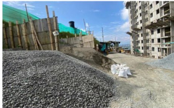
Imagen 20. Inexistencia de lleno actualmente, fue retirado para la construcción de las torres. Fuente propia
