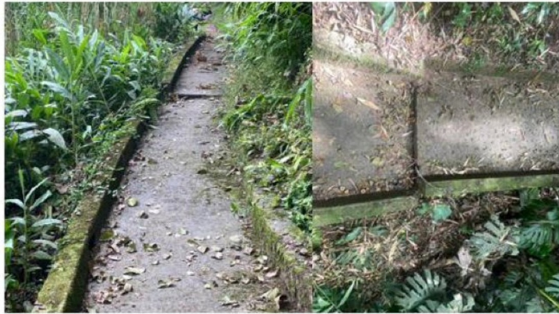
Imagen 21. Muestra del asentamiento que presentó el terreno, en Jardín Botánico de Universidad de Caldas. Fuente: Propia.
