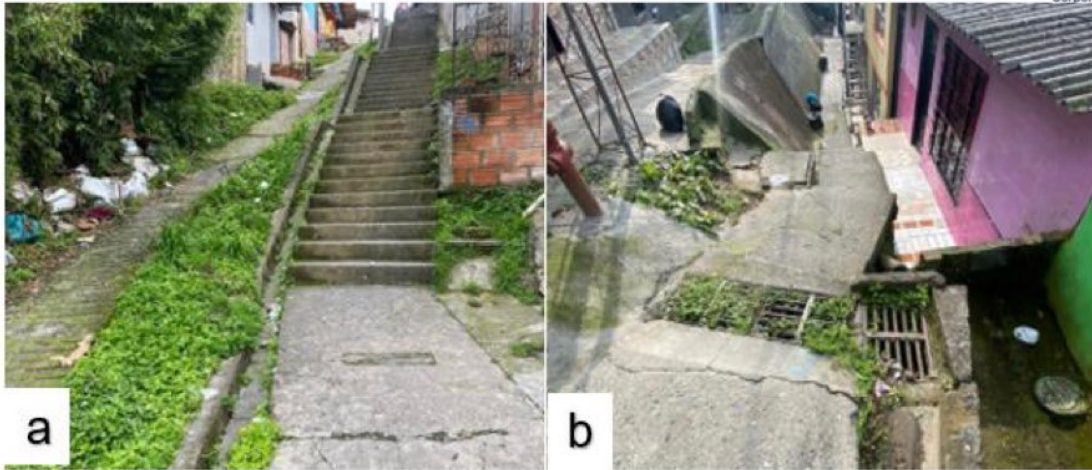
Imagen 15. Barrio Nevado. a) Estructuras de manejo de agua tipo canal. b) obras de estabilidad y sumideros para control de agua lluvia. Fuente: propia.
