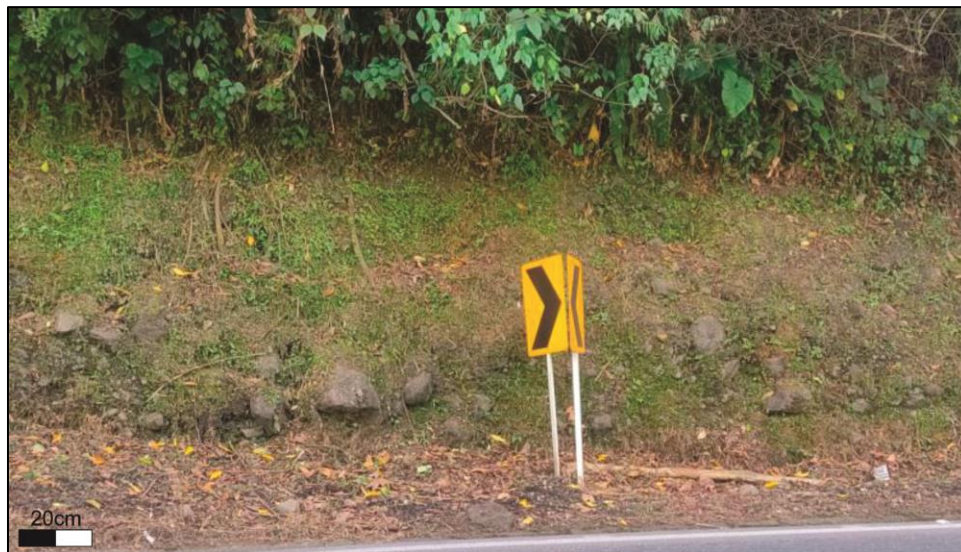
Figura 27. Depósito de flujos de lodo y escombros (Base).
