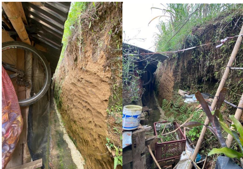
Imagen 8. Talud parte posterior afectado por aguas lluvias no canalizadas del techo de la vivienda y con un area socavada.
