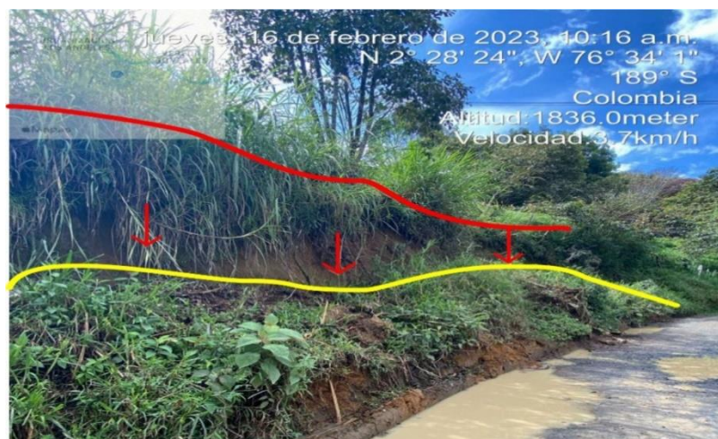
Imagen 1. Asentamientos del terreno al costado de la vía en la vereda El Paraíso.
