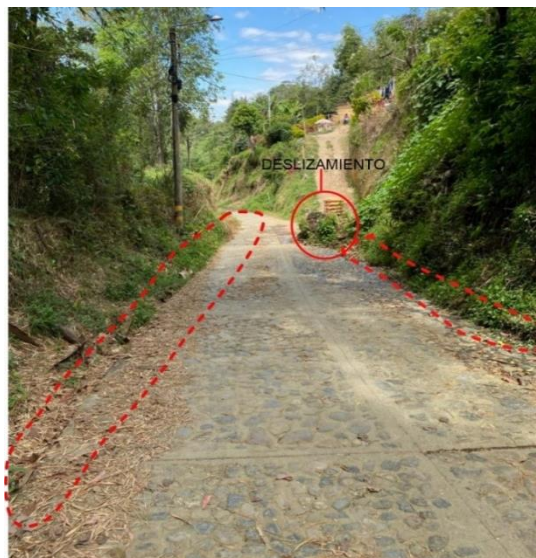
Imagen 6. Placa huella vereda El Boquero, sin canalización de aguas y un deslizamiento sobre la misma.
