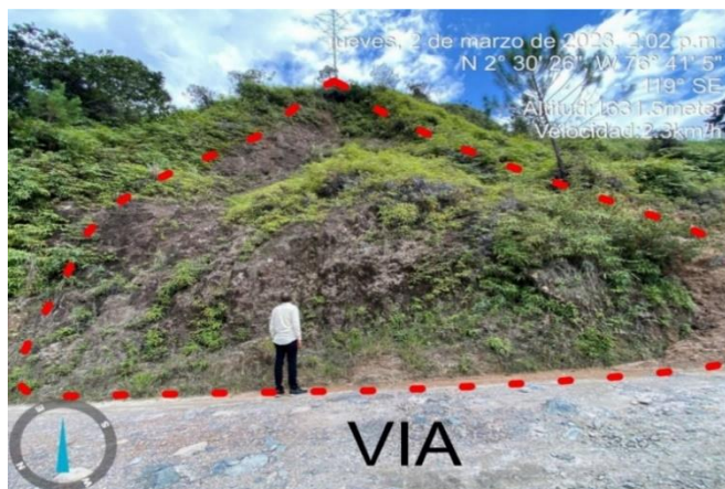
Imagen 15. Deslizamiento de aproximadamente 8 metros de alto a un costado de la Vía en la Vereda la Meseta.
