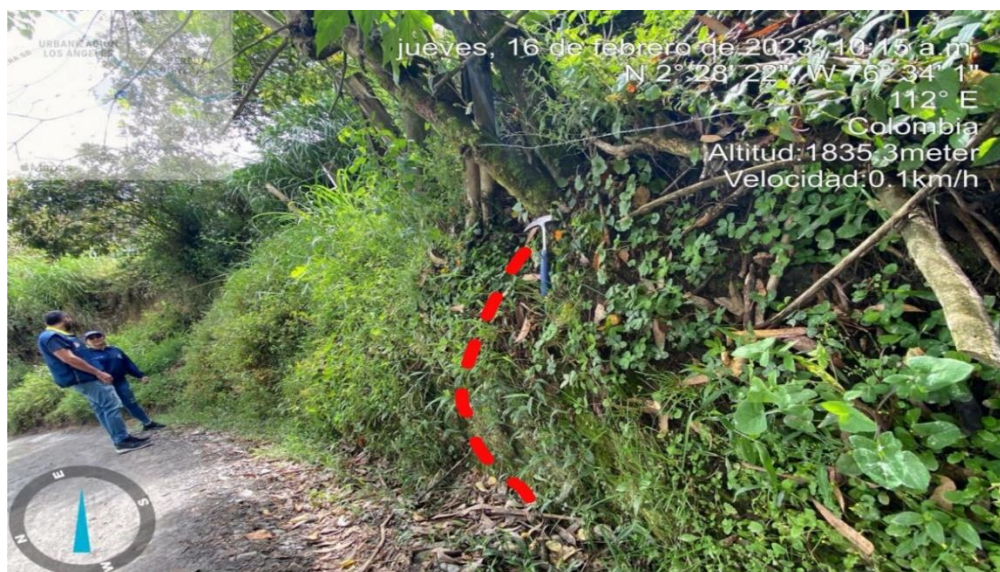
Imagen 4. Abultamiento al pie del talud a un costado de la vía de acceso a la vereda El Paraíso.
