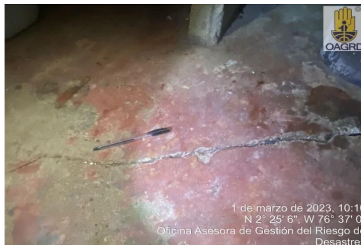
Imagen 13. Fisura en el suelo al interior de la vivienda
