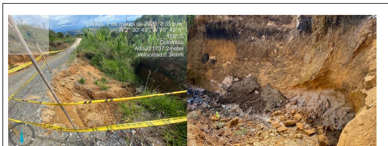
Imagen 18. Socavación a un costado de la vía que conecta la Vereda La Meseta y el Barrio Julumito.
