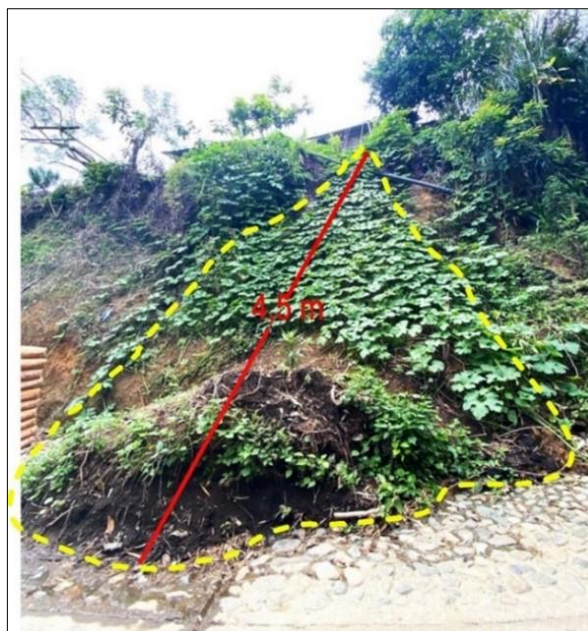
Imagen 5. Deslizamiento traslacional sobre la vía en la Vereda El Boqueron.
