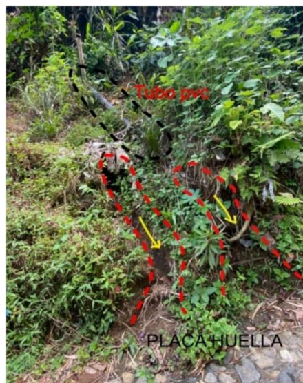
Imagen 11. Desagüe del agua de los canales, se observa como el agua socava el suelo antes de caer a la placa huella en la vereda El Boquerón.
