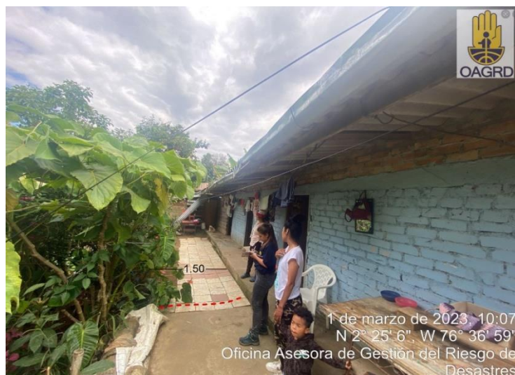
Imagen 9. Hundimiento del suelo en la parte frontal de la vivienda de la señora Margarita Cruz.
