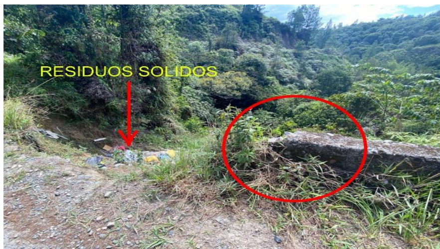
Imagen 17. Afectación de la vía y presencia de residuos sólidos sobre un deslizamiento
