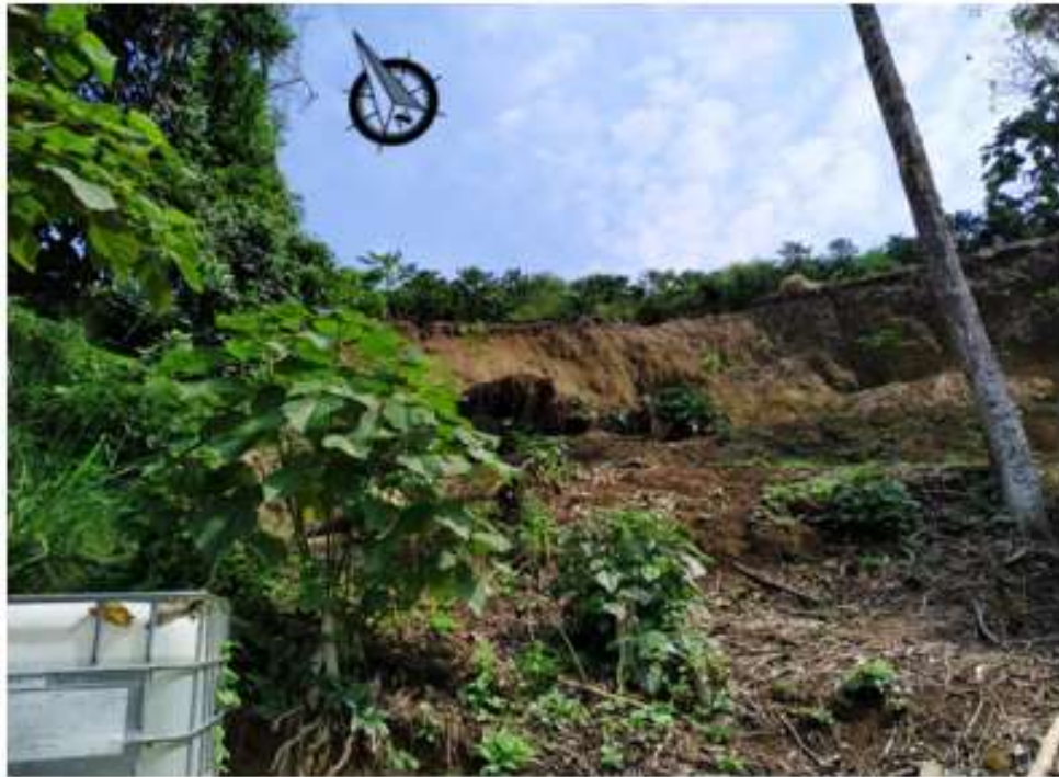
Figura 25. Ejemplo de deslizamiento en suelo piroclástico.
