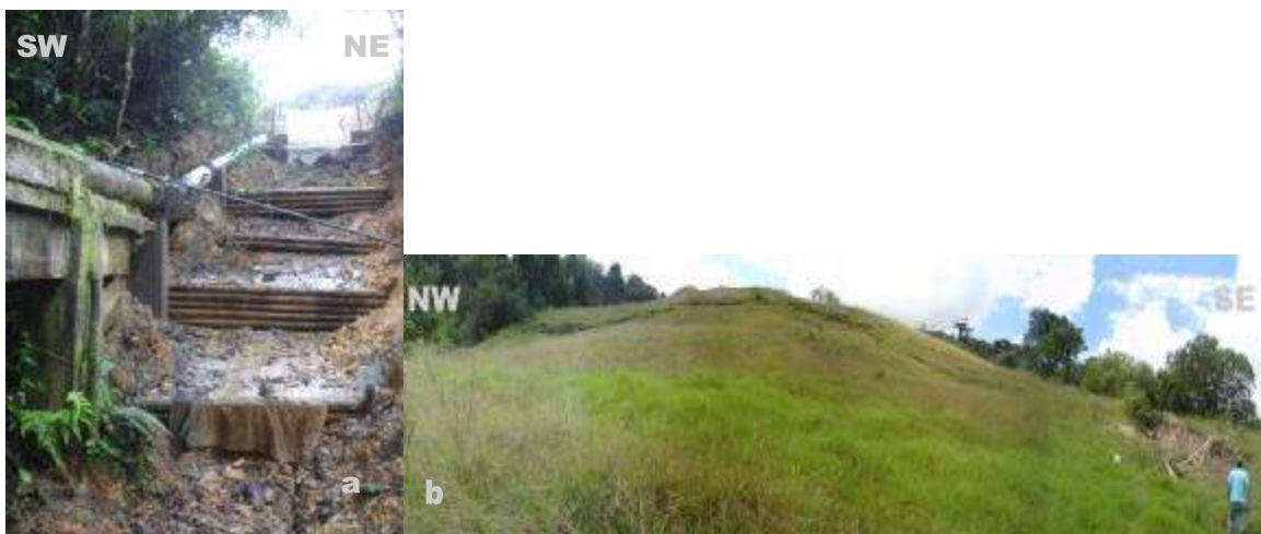
Figura 18. Obra de mitigación sin control de drenaje (a) y grieta de tensión, en línea punteada, en la parte alta de la ladera (b)
