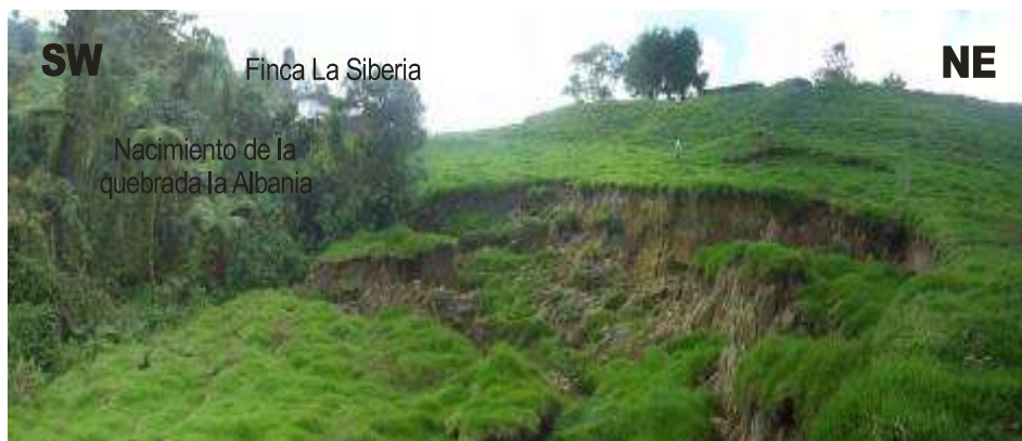
Figura 11. Movimiento en masa tipo deslizamiento compuesto que se presenta en predios de la finca La Siberia cerca al nacimiento de la quebrada La Albania.
